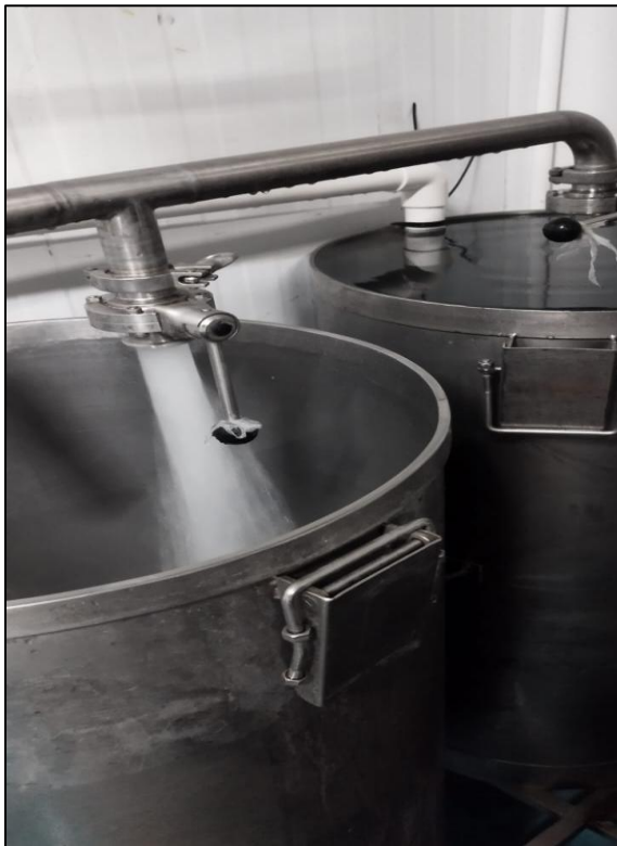
Figura 2. Llenado de agua potable en marmitas para inicio de CIP
